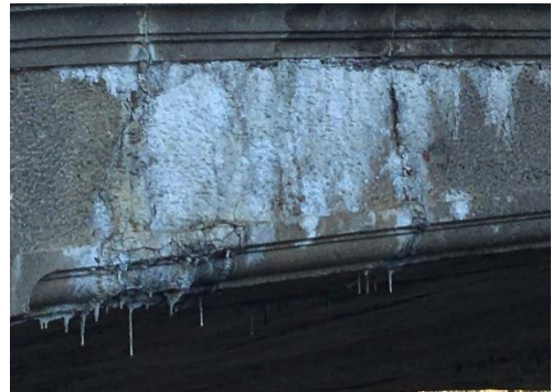
Rys. 5. Wycieki w płycie przęsła, rysa pionowa chodnikowych
