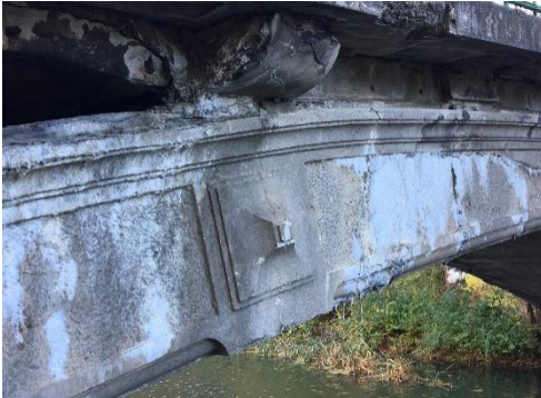
Rys. 2. Nacieki i uszkodzenia płyty i wspornika
