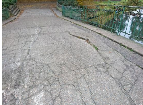
Rys. 3. Spękania nawierzchni betonowej
